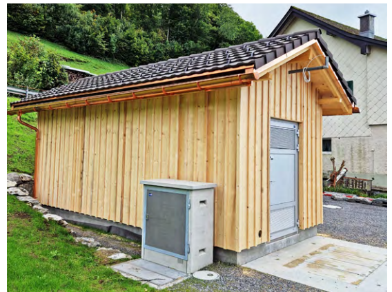
Trafostation Beglingen 18a in Mollis nach der Erneuerung
